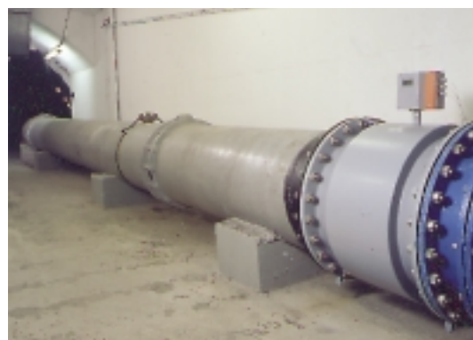
Typisk installasjon av mengdemåler DN 800 i vannverk
